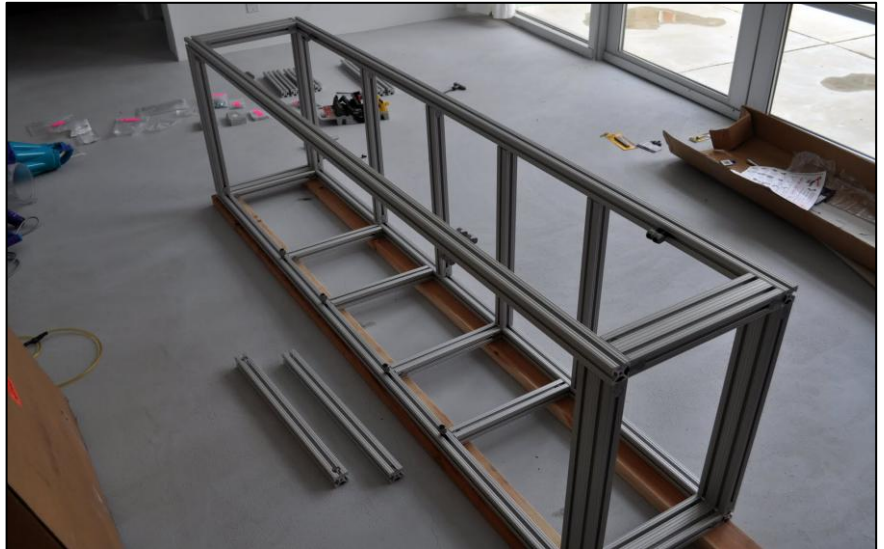
Voor het monteren van de aluminium delen zijn de onderste horizontale liggers tijdelijk op houten balken gezet, waardoor een vlakke montage mogelijk wordt.
