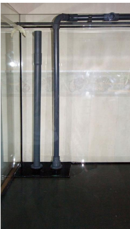
De overlooppijp bestaat uit twee delen, via de mof kan je de waterhoogte iets regelen.
