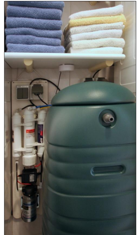
Onze installatie staat in de badkamer
