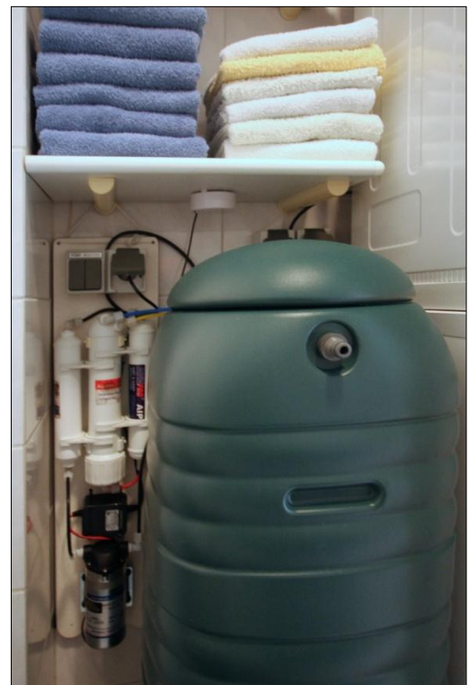
Onze installatie staat in de badkamer
