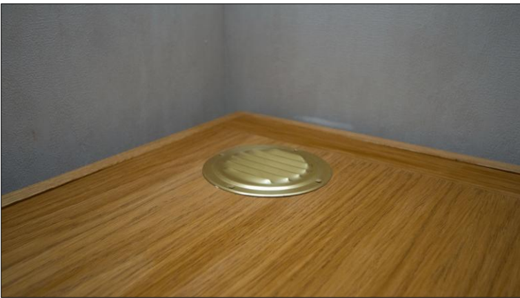
De lichtkap is voorzien van twee ventilatie roosters.
